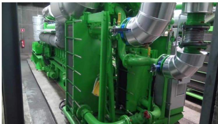
Slika 1: Dva modula INNIO Jenbacher za soproizvodnjo toplote in električne energije
