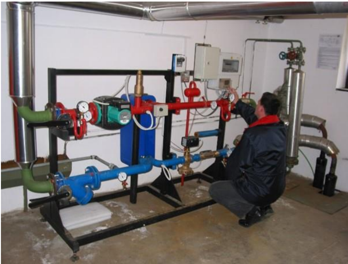
Slika 5: Kontrola delovanja indirektna toplotne postaje
